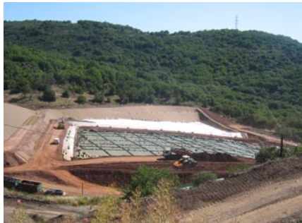
Le traitement par enfouissement à l'ISDND de Soumont
